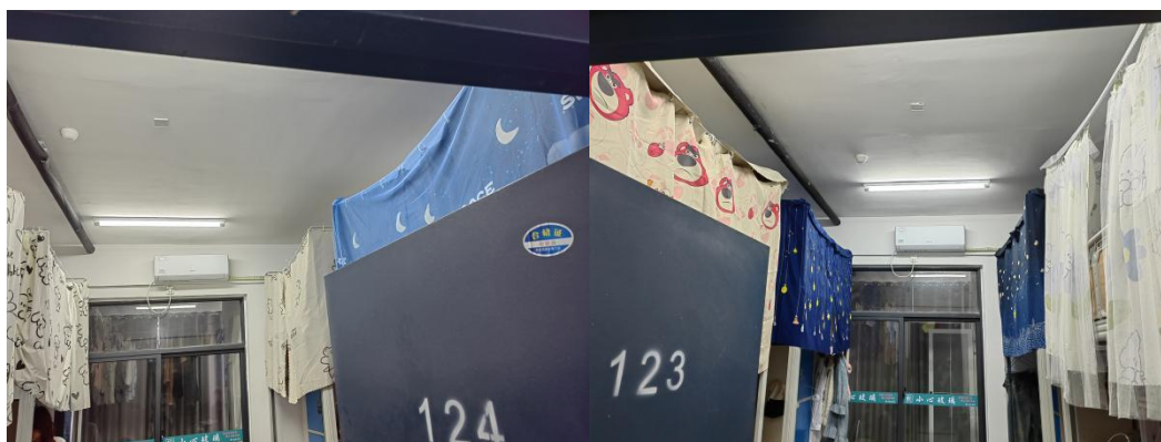
5. 12#101 宿舍、105 宿舍，挂有床帘，存在安全隐患；班级：助产 23302
